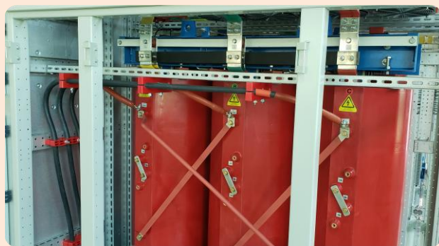
高压 / 低压输入输出变压器
